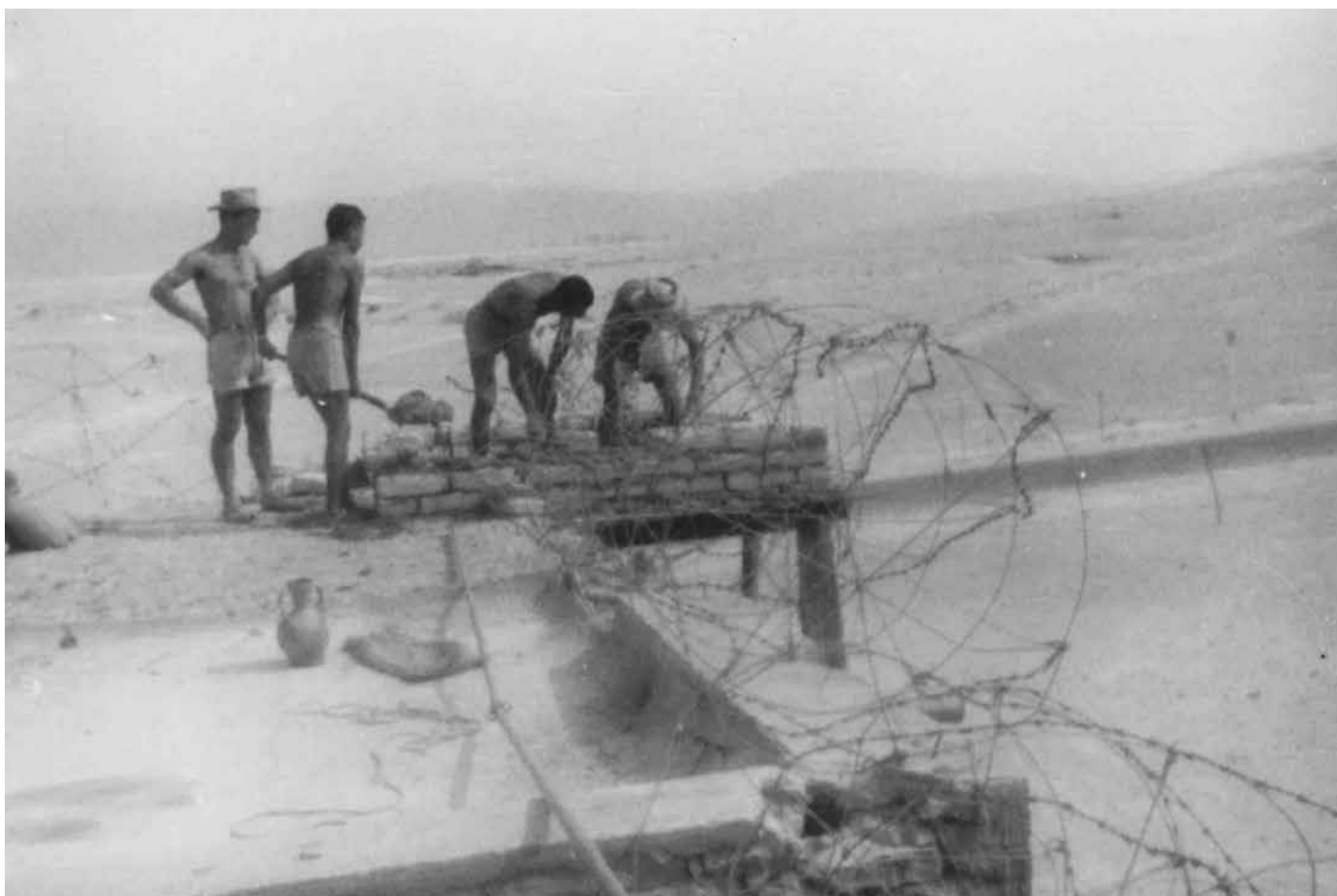
▼ Construction du poste de garde (le Lot 7 a détruit un mur pour récupérer les parpaings)
