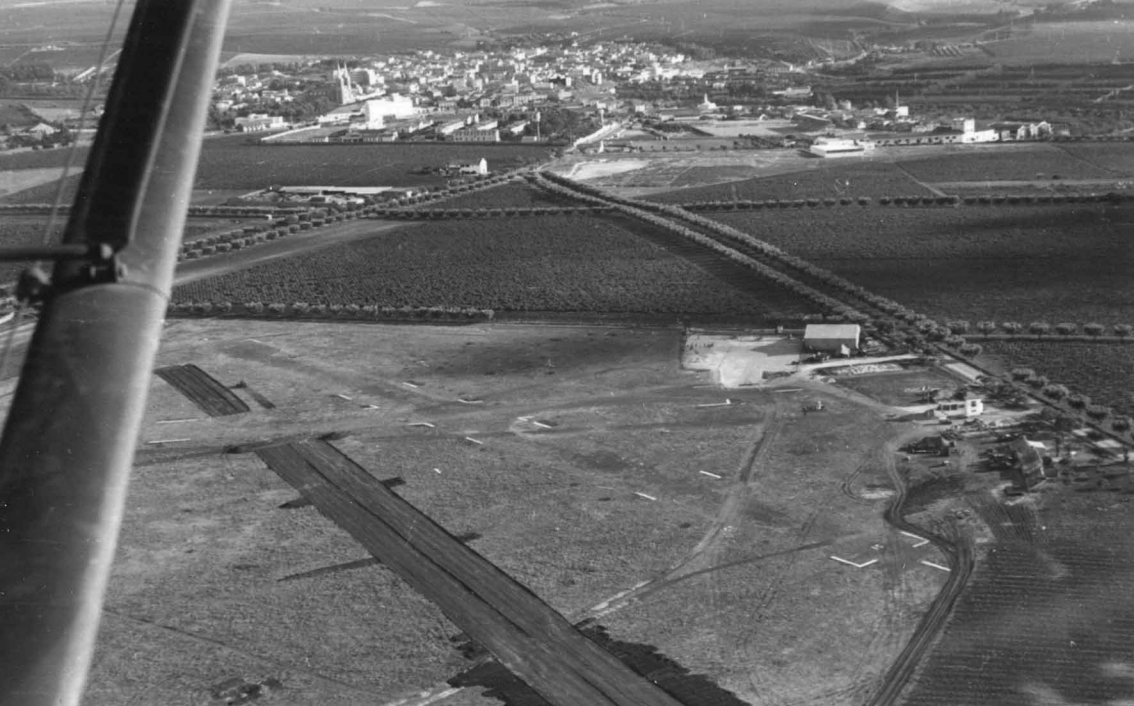
L'aérodrome d'Aïn-Témouchent en 1957, pendant la construction de la nouvelle piste (Claude Marigot)
